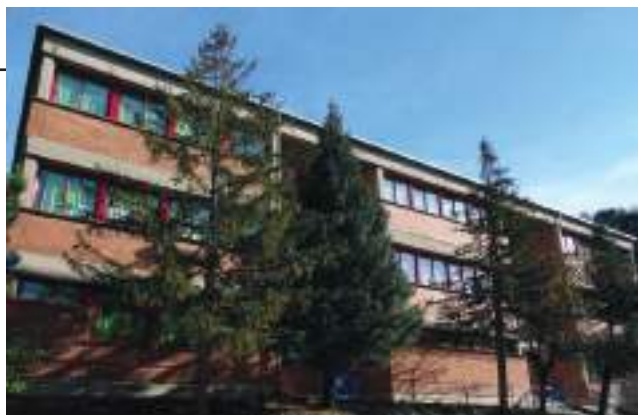
Degradació a la façana de l'escola Santa Eulàlia. JOSEP LLUSSÀ
