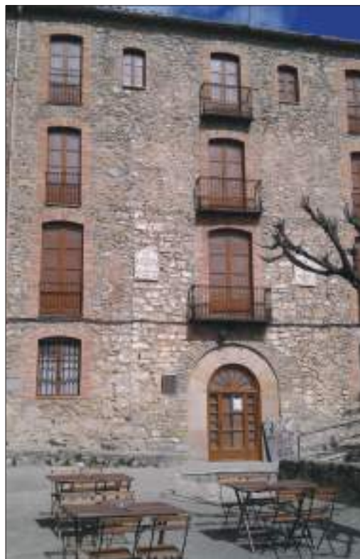
Vidres nous i finestres pintades, a la façana. Aquí
