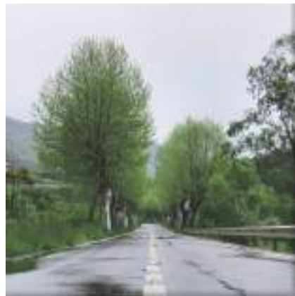
Carretera després de la pluja @ramunxituu
