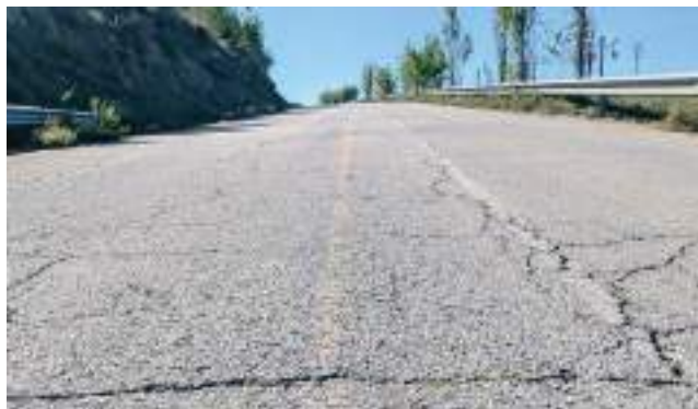
Desperfectes a les vies de servei, a l'altura de Cal Vidal i Cal Blau. M.C.
